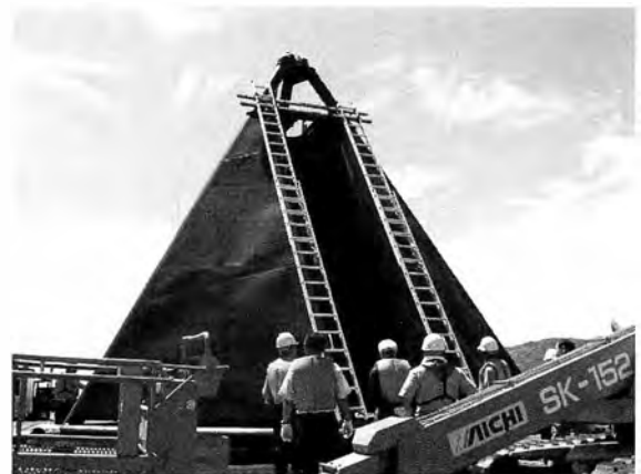
図2 羅臼漁港沖に敷設された海洋深層水取水管の取水口 （高さ8.5 m、底辺9.8 mの三角錐形）
