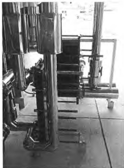
排熱回収用熱交換器（熱交換器 1）：奥 温水加熱用熱交換器（熱交換器 2）：前
