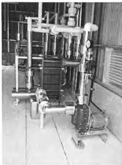
排熱回収熱交換器（熱交換器 1）と排水ポンプ
